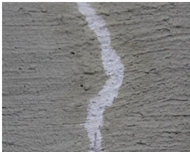
Foto 4. Schließen des Risses durch Salzkristalle, kein Sickerwasser. Ergebnis nach 21 Tagen.
