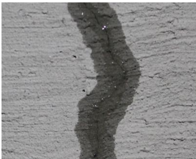
Foto 1. Abdichtungsschicht aus ATLAS WODER SX auf einer Betonoberfläche – Wasserdruck von innen. Leckage an einem Riss im Untergrund.
