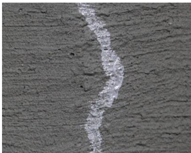
Foto 5. Langsame Ansammlung von Salzkristallen auf der Oberfläche des Risses, Versiegelung. Ergebnis nach 35 Tagen.
